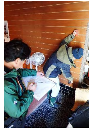
傾斜を測る被災建造物2次調査の様子
