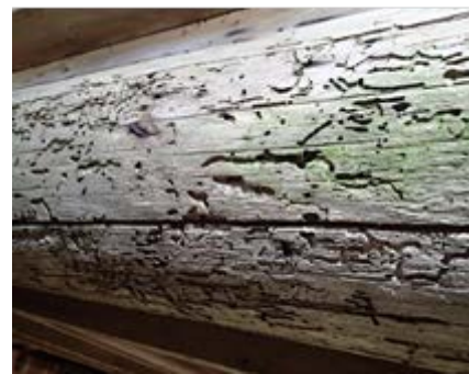
木造建造物の甲虫被害
