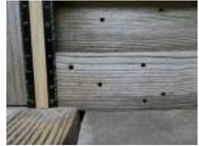
木造建造物に発生した虫害
