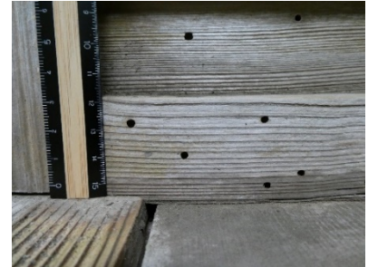
木造建造物に発生した虫害
