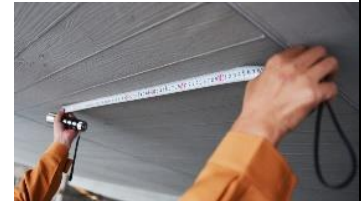
再現した型枠木目の確認 （広島平和記念資料館）
