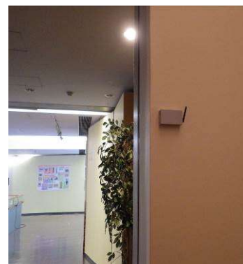
温湿度センサーの設置状況
