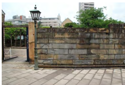
図1 出島旧石倉の表面劣化状態
