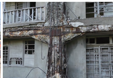
端島（軍艦島）の劣化した鉄筋コンクリート造集合住宅
