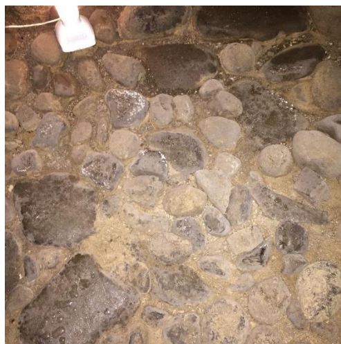
石室床面で発生した結露
