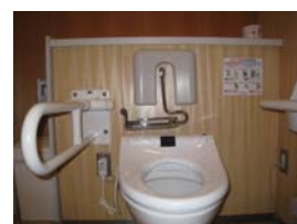
オストメイト対応設備
